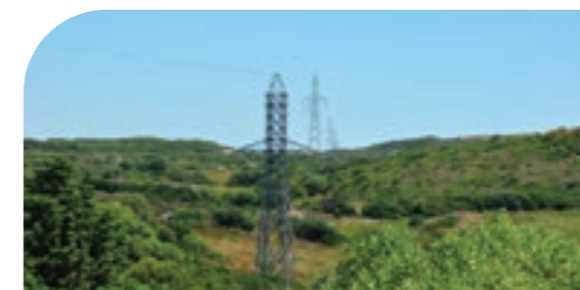
Ligne électrique SACOI (Sardaigne-Corse-Italie)
